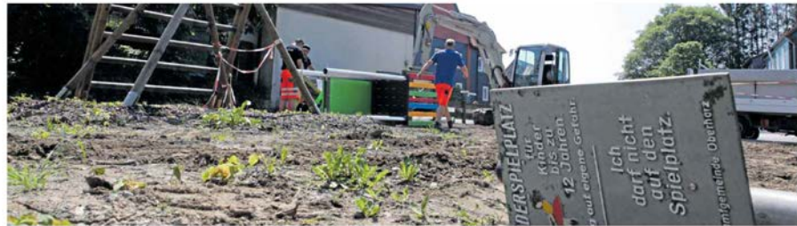
Mitarbeiter des Baubetriebshofes verwandeln die derzeit wüste Fläche wieder in einen Spielplatz mit bunten Geräten. Foto: Bruns
